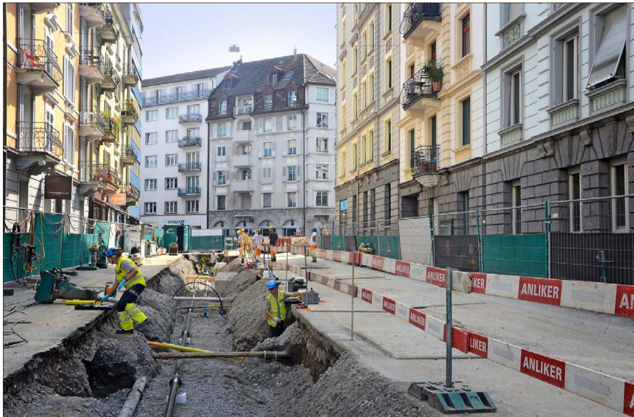
Die Ratten fühlten sich in den alten Leitungsrohren der Dornacherstrasse pudelwohl.
